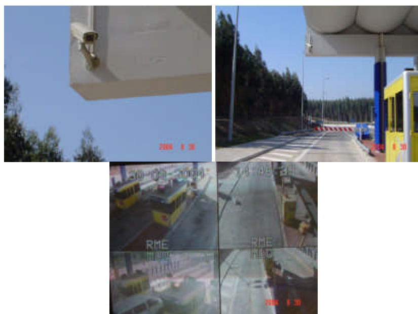
Fig. 3 – Sistema de CCTV
